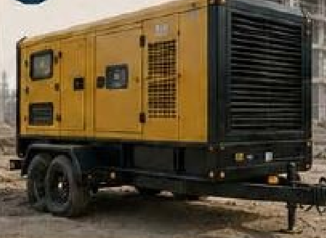
مولد كهرباء مؤقت Generator
